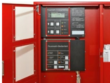
Brandmeldeanlagen erkennen Brände frühzeitig und alarmieren schnell die Feuerwehr sowie die Menschen im Gebäude.
