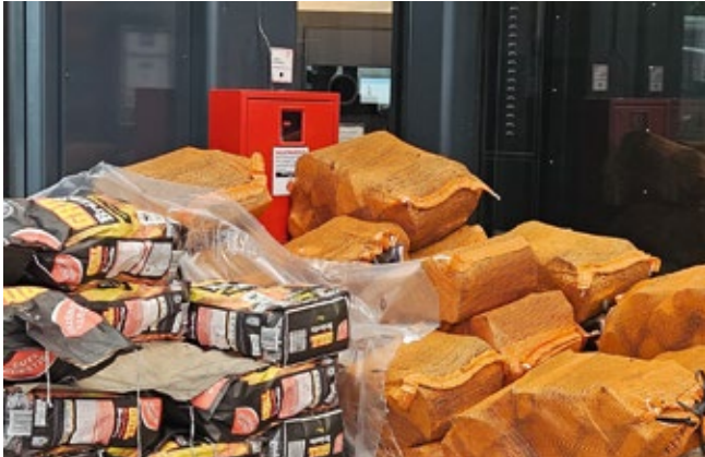
Im Brandfall kritisch: Die Bedienstelle für die RWA-Anlage ist nur schwer erkennbar.
