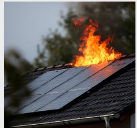
Bei Kurzschlüssen können PV-Anlagen Brände von außen ins Innere von Gebäuden übertragen.
