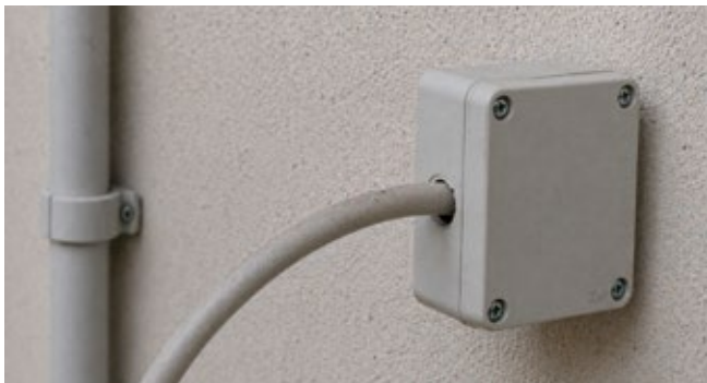
Nicht ausreichend fixiert und nicht abgedichtet! So darf es nicht aussehen!
