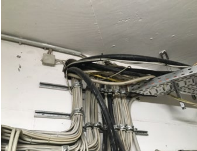
Unkontrollierter Wanddurchbruch: im Brandfall eine gefährliche Schwachstelle.
