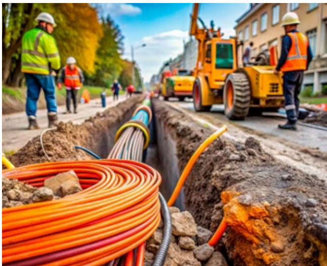
Baumaschinen dürfen nicht an Haussteckdosen angeschlossen werden – dafür gibt es Baustromverteiler.
