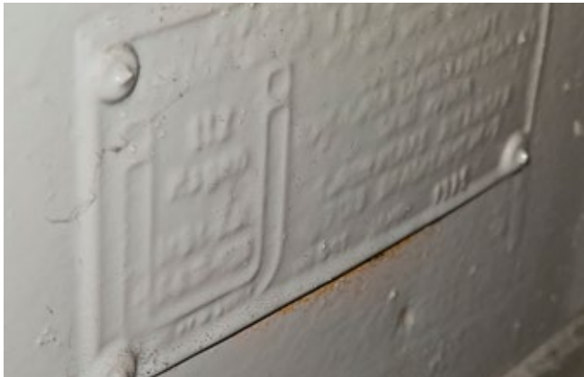
Gut gemeint, schlecht gemacht: Ein übermaltes Typenschild verhindert die Zulassungsprüfung der Brandschutztür.
