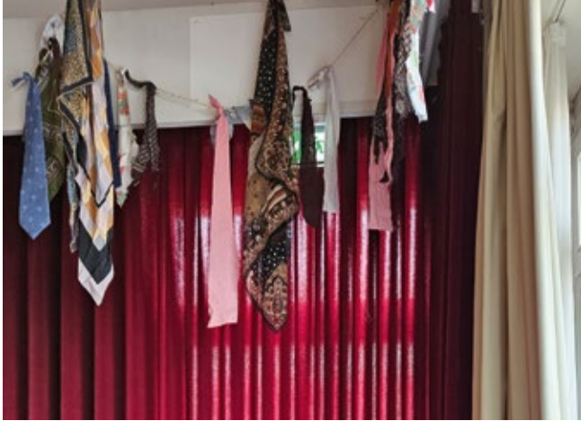
Diese Deko verdeckt das Notausgangsschild und erfüllt nicht die B1-Anforderung für schwer entflammbares Material.
