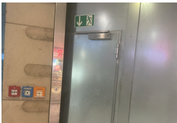
Blockierte Brandschutztür: Der Fluchtweg ist versperrt und im Ernstfall nicht nutzbar.
