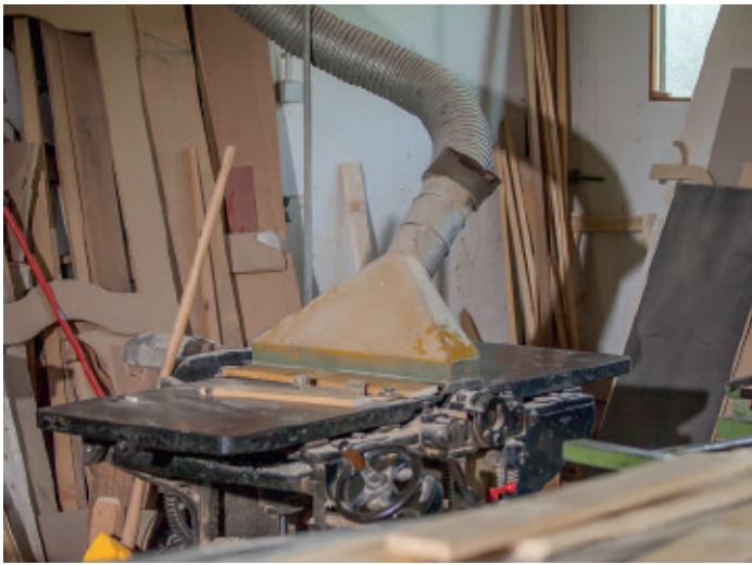
Unsichtbare Gefahr: Wartungsarbeiten an Absauganlagen erfordern höchste Vorsicht und Verantwortung.
