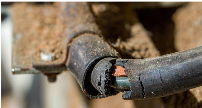
Defektes Kabel bedeutet akute Brand- und Stromschlaggefahr!
