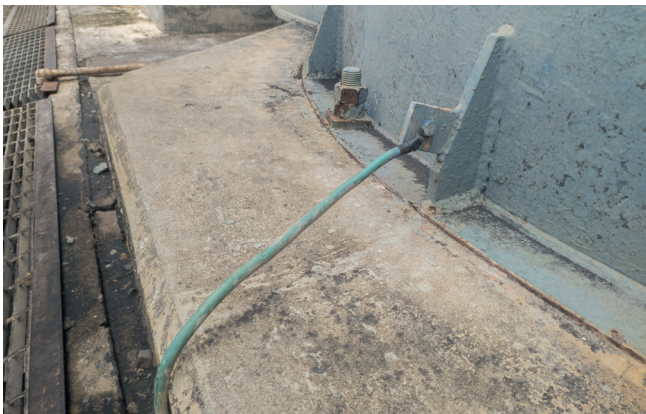
Schlecht sichtbar und ungesichert stellt eine solche Stolperfalle eine potenzielle Unfallgefahr dar.
