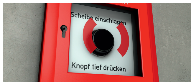
Technischer Brandschutz – mehr als nur Feuermelder!
